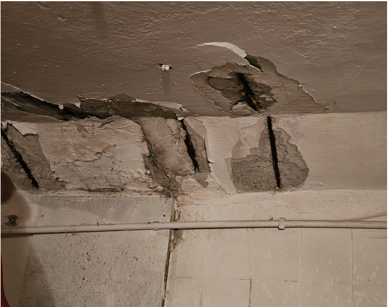
Fotografia numer 13. Widok na miejsce numer 10, zaawansowana korozja zbrojenia i przeciek.
