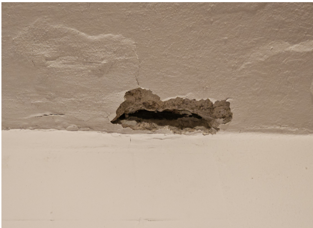
Fotografia numer 12. Widok na rozkute miejsce numer 9, w którym dokonano wcześniej naprawy.
